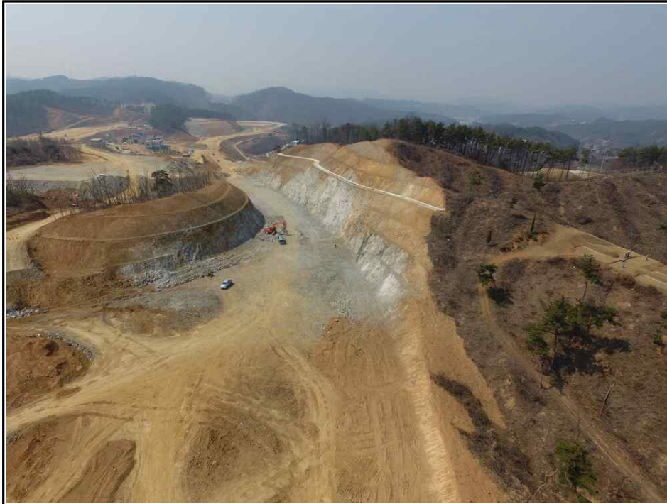
【그림 3】 깎기비탈면 시점부 측면 사진
